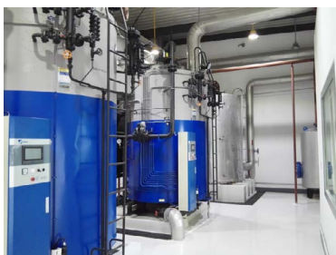
▲ 制剂楼燃气锅炉
